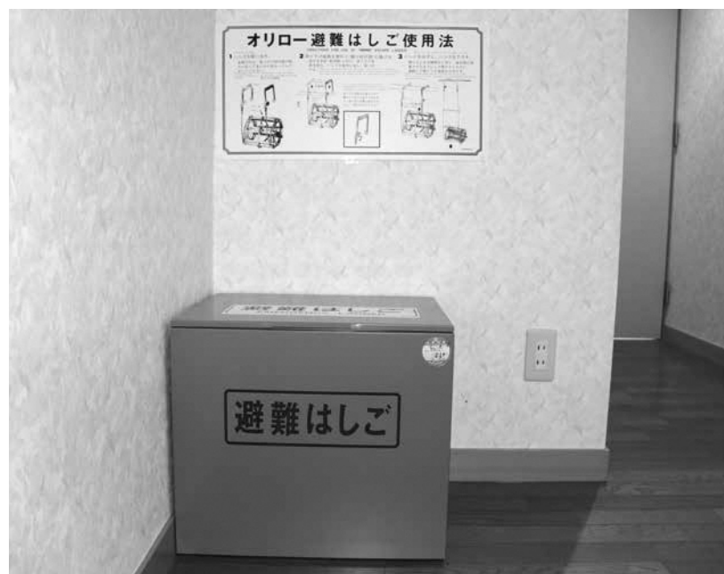
2階建て以上の公共施設に設置されている避難器具（避難はしご）
