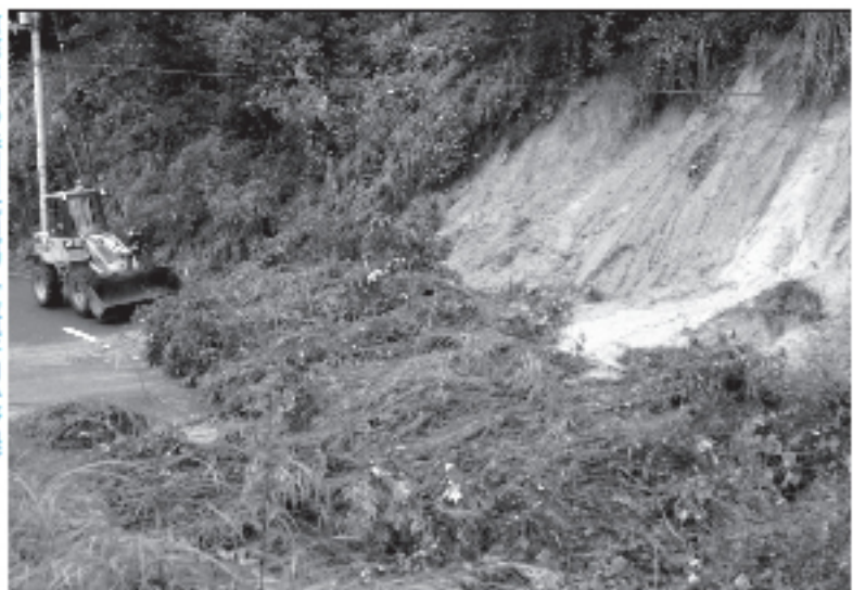
崖崩れ内の法面崩落現場（県道平田小野線）
