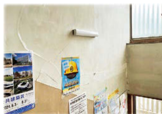
▲多数のひび割れ(2階)
