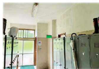
▲多数のひび割れ(1階)
